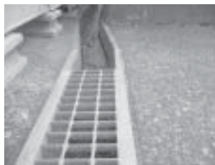
排水路の側溝（特に土砂 がたまっている場所）
